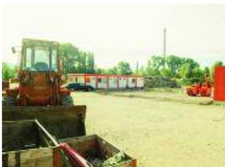
L'entreprise Colas, qui en est au tout début de son installation, va encore construire des unités de stockage de matériaux. DAVID MARCHON
